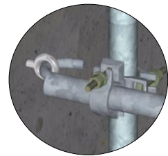
Barre d'amarage + piton d'amarage fixé au mur par une cheville à béton.
